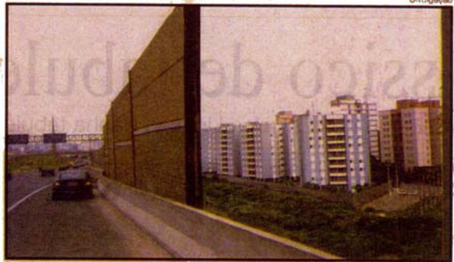
Barreira acústica, em fase de teste, no acostamento da rodovia dos Bandeirantes
